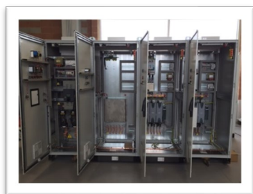
Armoires de commande
