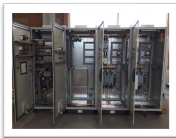
Armoires de commande
