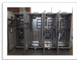
Armoires de commande
